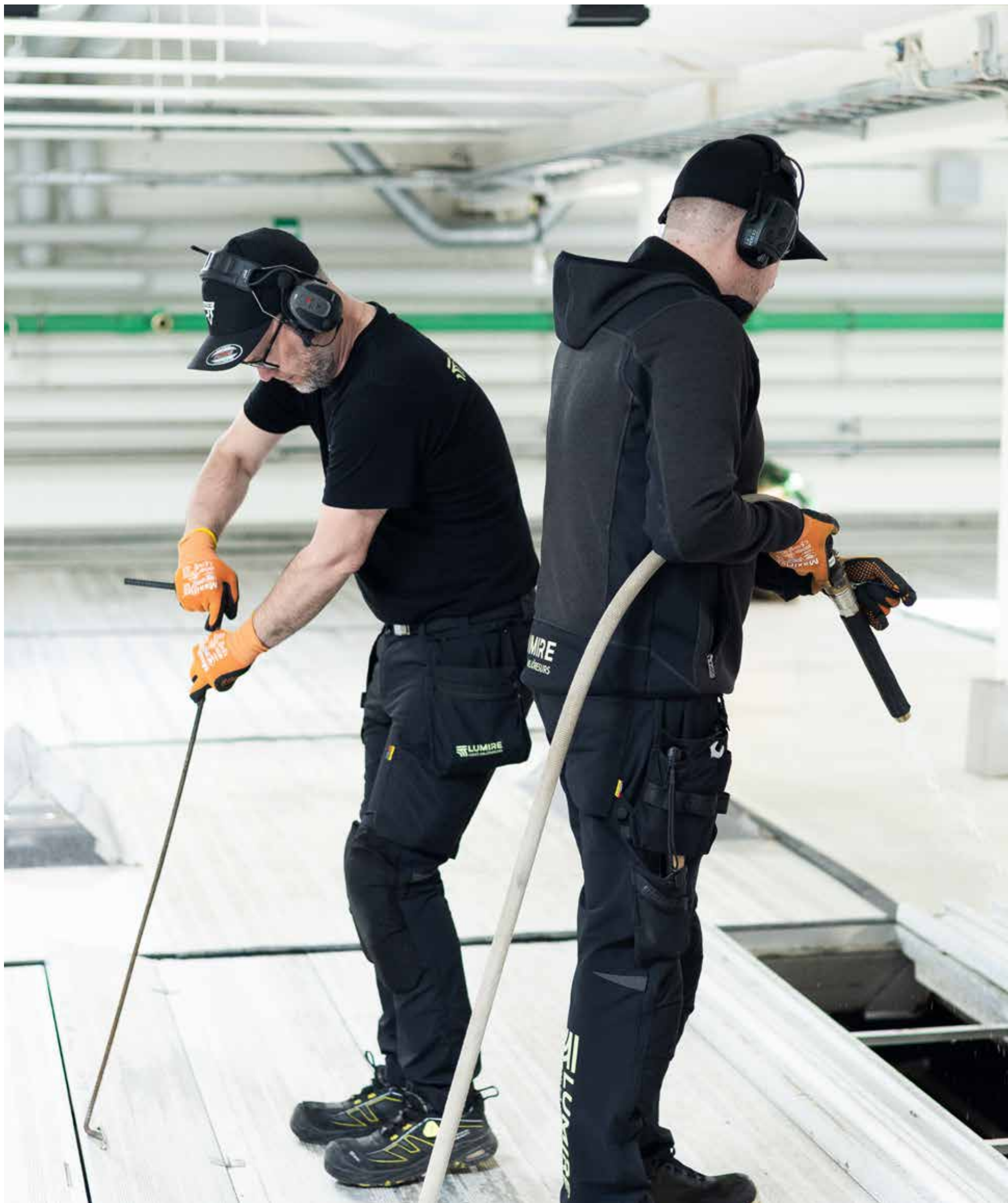
Spolning av bassänger på Uddebo avloppsreningsverk
