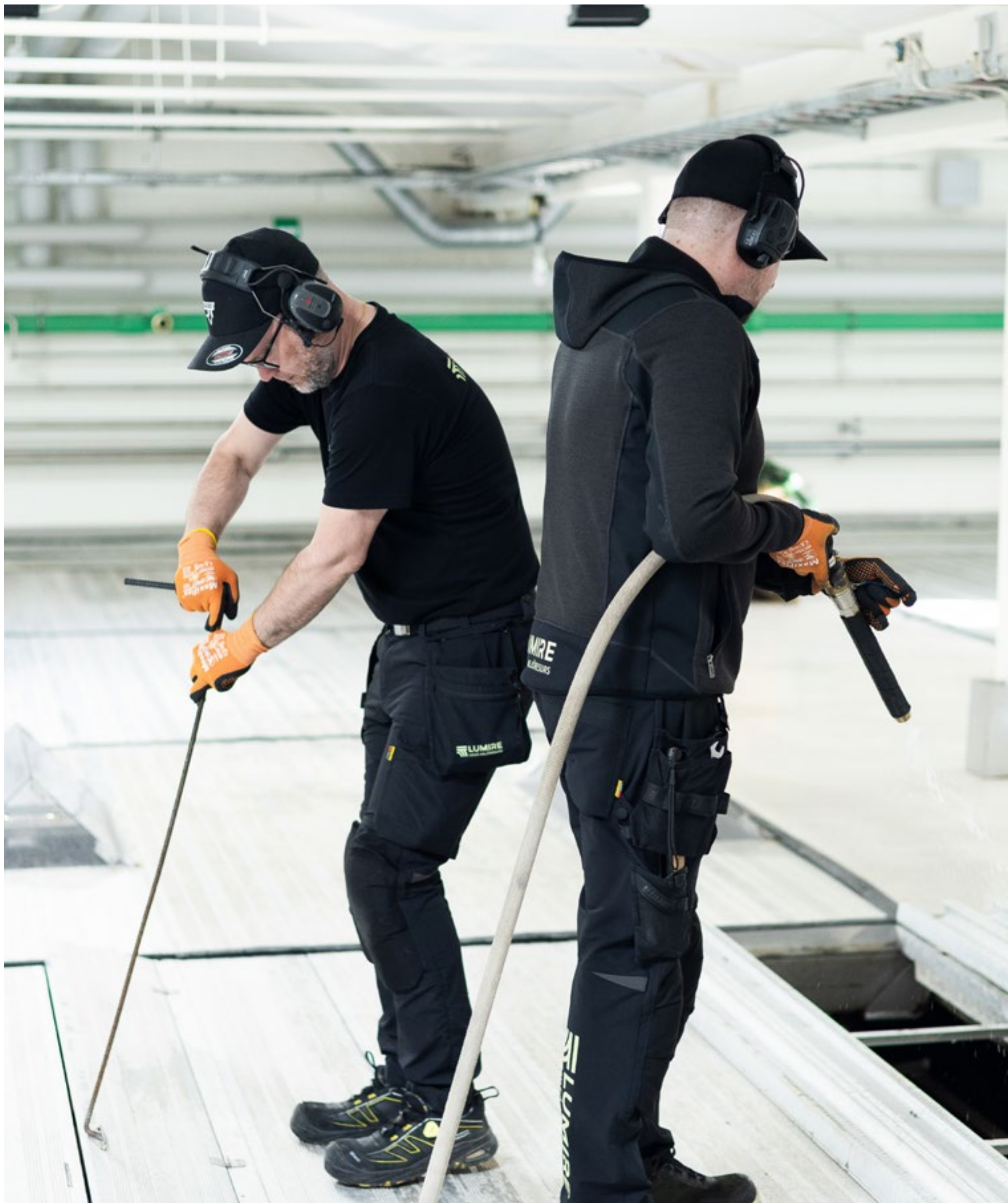
Spolning av bassänger på Uddebo avloppsreningsverk
